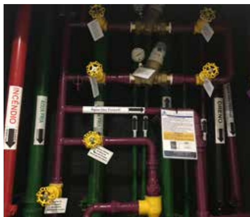
Foto 5.2. Foto do shaft com tubulações de água potável, incêndio, drenagem e água de reúso devidamente identificadas no empreendimento Vista Clementino
