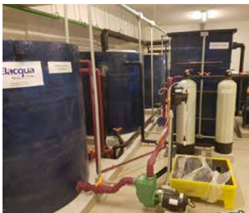
Foto 5.1. Estação de tratamento de água cinza clara (ETAC) implantada no empreendimento Vista Clementino
