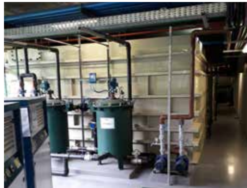
Foto 1.2. Estação de tratamento de esgoto
