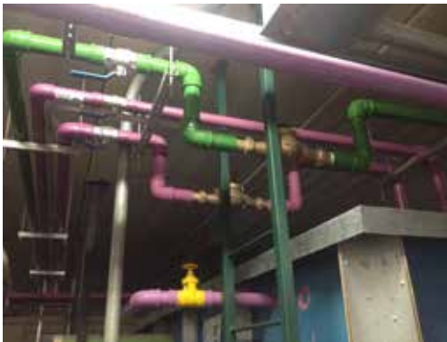
Foto 1.1. Tubulações devidamente identificadas por cores (magenta – água de reúso; verde – água potável)
